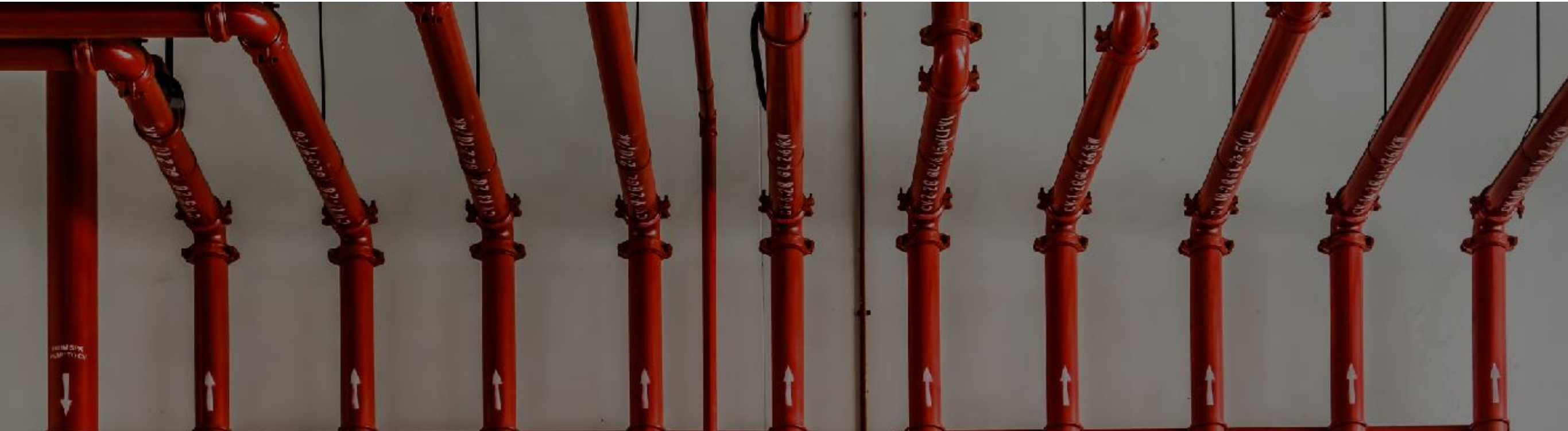
Tubería contra incendios
